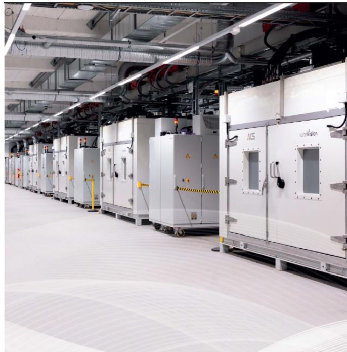
Camera di Prova per Batterie
