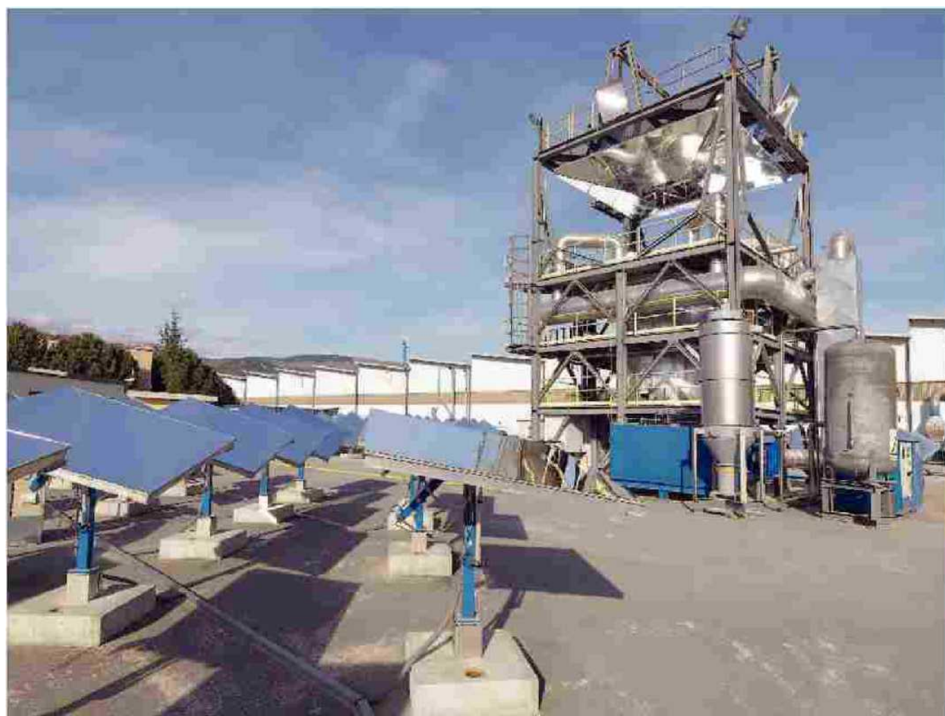
Il prototipo del sistema per la generazione di elettricità con metodo solare termodinamico
